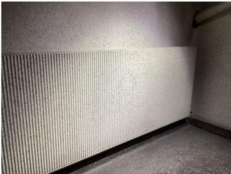
Eksisterende radiator trapperom, bygningsdel C, Mack øst
