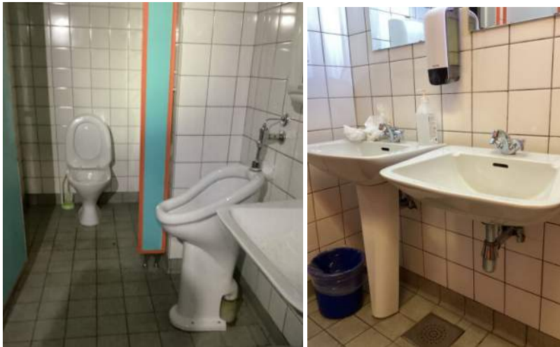
Toalett, pissoar og vask fra 4. etg bygg C
