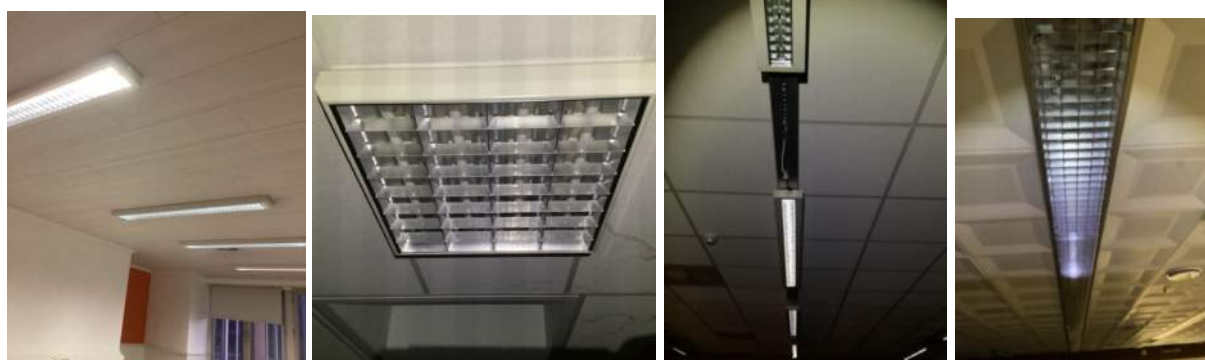
Ulike typer lysarmaturer av nyere dato fra kontorlokalene
