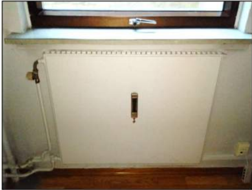
Original radiator i KA13. Foto: Anne S Nordby
