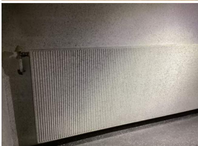
Øverst: Radiator i kontorlokale 4. etg bygg C. Nederst: trappeoppgang nord i bygg C
